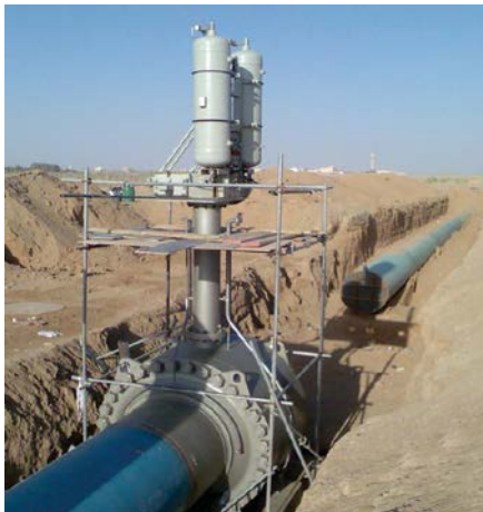
Пример аккумулятора, который установлен на клапане аварийного отключения
